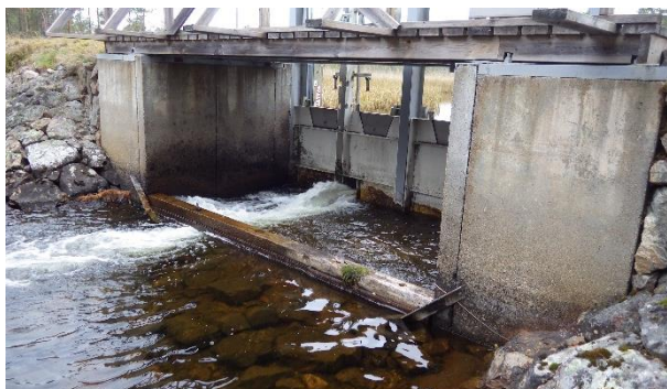
Dammens utskov är försett med två hydrauliskt drivna, 2 m breda reglerluckor av järn. I den västra luckan finns ett bottenutskov för minimitappning och tänkt fiskvandring. Detta vilket är endast 0,32x0,32 m stort regleras mekaniskt med en lucka.
