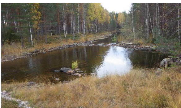
Området nedströms dammen består av ett långt sel som omges av flack skog beväxt av småväxt tall och mindre inslag av björk. Ca 25 m nedströms dammen (mitt i bild) finns en anlagd, nivåhållande sten tröskel.
