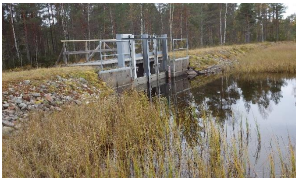
Tälningssdammen är inbunden i en 75 m lång jorddamm i Tälningens södra ände. Själva dammen är byggd i betong med en 8 m bred kropp, samt ett 4 m brett utskov.
