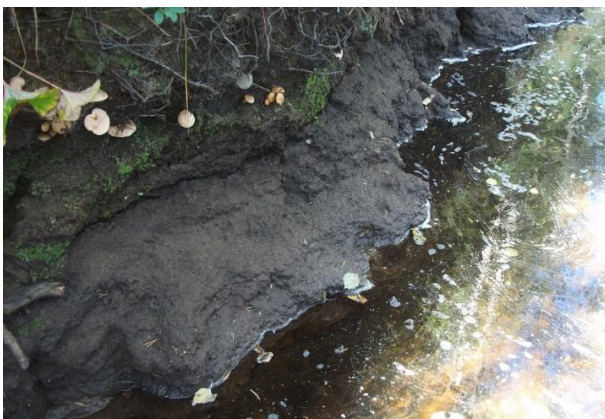
Erosion som grumlar vattnet i kanalen.
