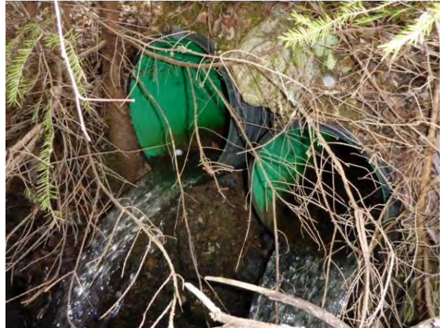
Vh 3. Dåligt anlagda vägtrummor i Råkasjöbäcken.
