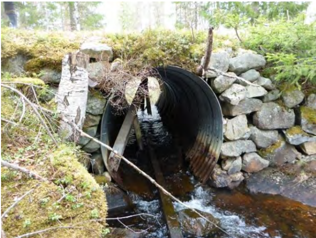
Vh 6. Dåligt anlagd vägtrumma i Nydammsbäcken.
