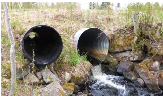
Dåligt anlagda vägtrummor i Klappbäcken.
