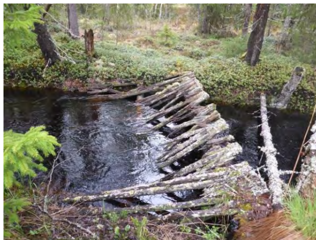
Raserad snöskoterbro som riskerar att bli ett vandringshinder.
