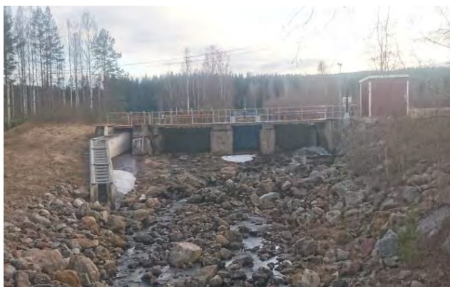
Älvkarheds kraftverk, Frösteboån, med torrlagd fisktrappa till vänster i bild.
