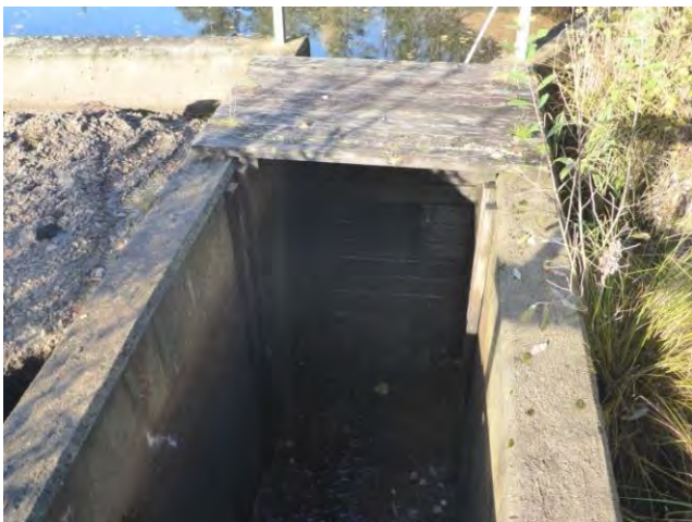
Intaget till fisktrappan som vid inventeringstillfället var helt torrlagd.
