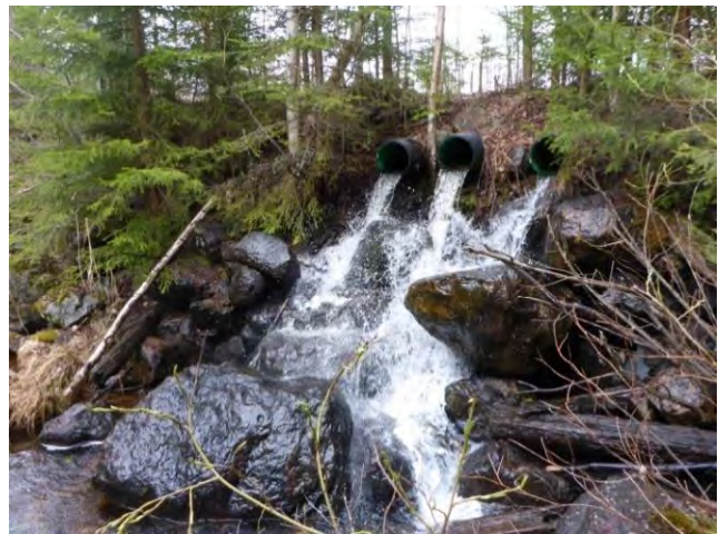
Vh 4. Tre vägtrummor i dammvall i utloppet av Nydammen. Fallhöjd 2 m.
