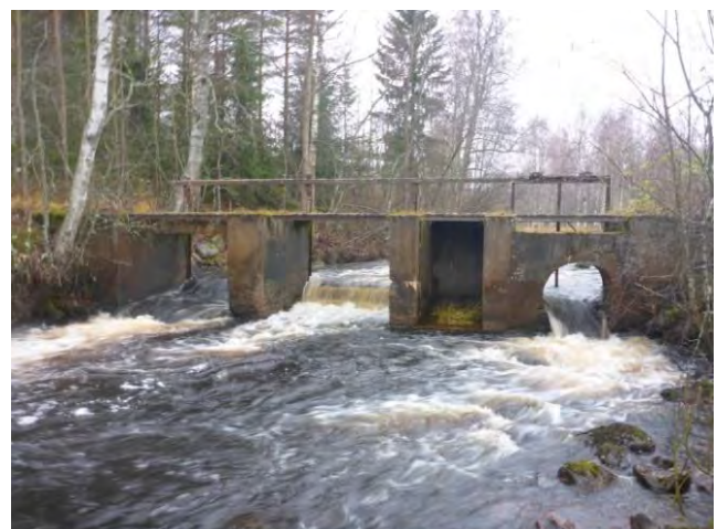
Vh 6. Delvis utriven kraftverksdamm nedströms smedjedammen i Ullungfors.
