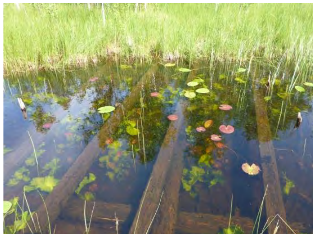
En av de raserade skoterbroarna efter den första sträckan.
