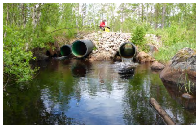
Vh 4: Tre dåligt anlagda vägtrummor. Dessa bör ersättas med en bred valvbåge eller en bro.
