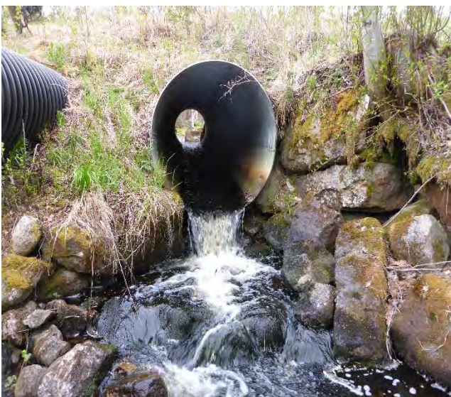
Bild på vandringshinder 15. Den sista vägtrumman närmast mynningen i Voxnan. Ett definitivt vandringshinder
