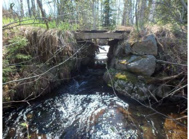
Vh 1. En dåligt anlagd vägbro.
