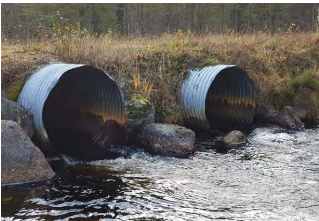
Vh 7. Två st. dåligt anlagda vägtrummor.
