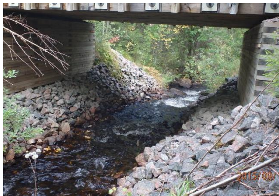
Träbalkbro där det tidigare funnits en felaktigt anlagd vägtrumma. Foto: Bertil Nääs.
