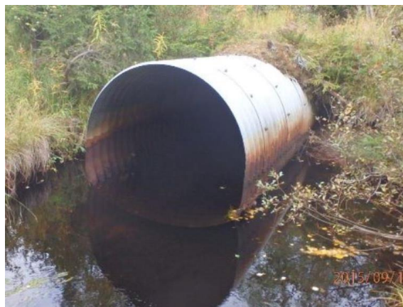
Vh10. Defekt vägtrumma. Foto: Bertil Nääs.
